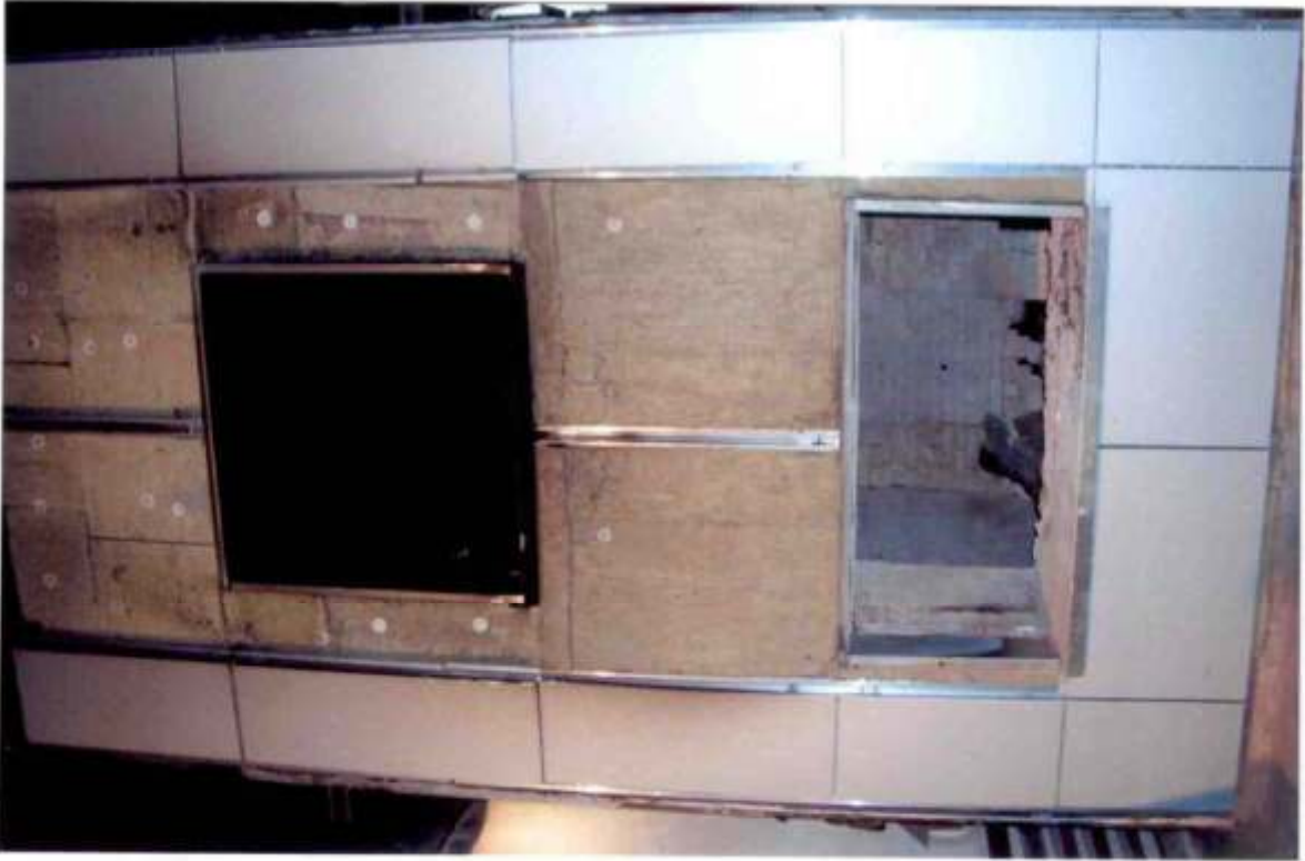
Фото №6 (образец после вскрытия конструкции)
